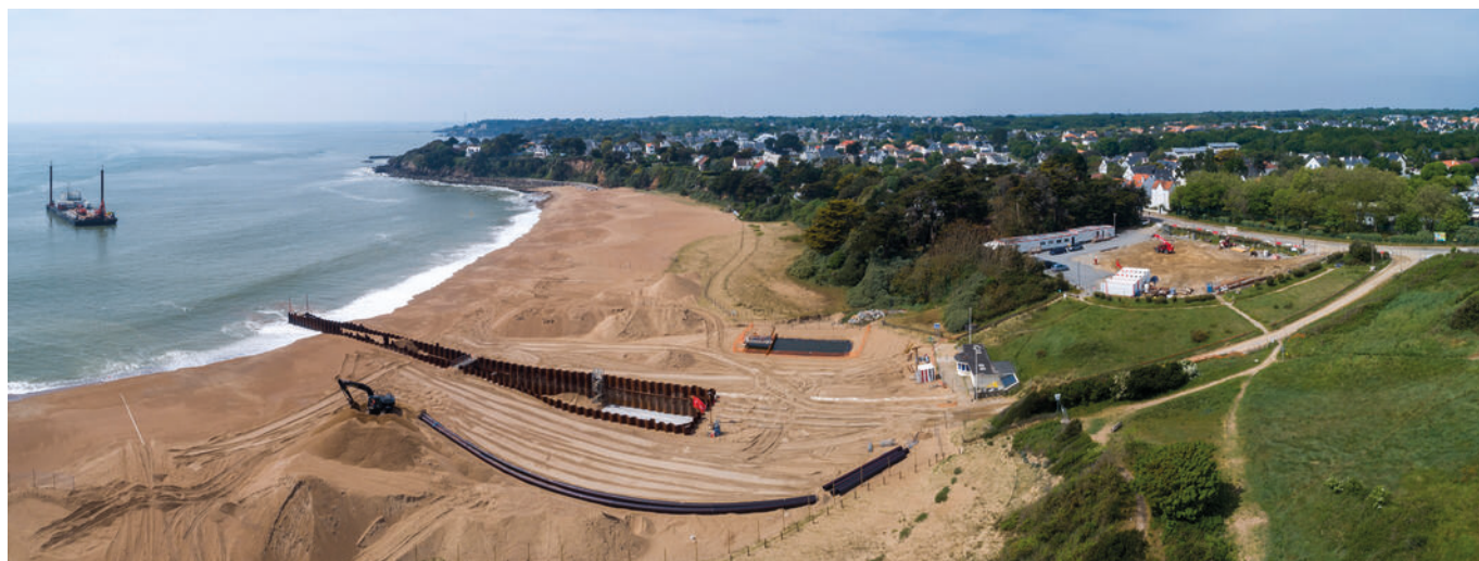
Exemple d'un atterrage sur la plage de la Courance à Saint-Nazaire
