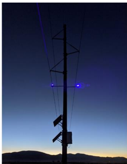
Figure 1 : Système ACAS installé aux Etats-Unis (EDM)
