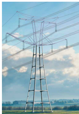
Pylône nouvelle génération
