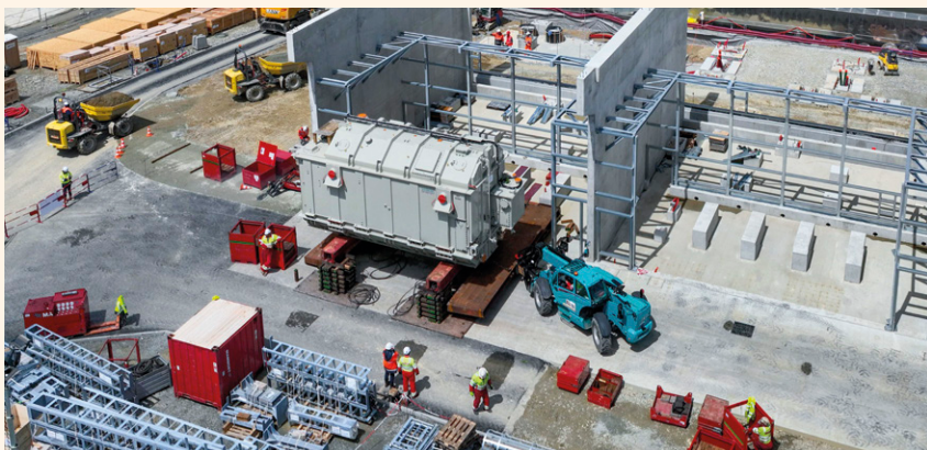
Arrivée du premier transformateur à la station de conversion de La Martyre.
