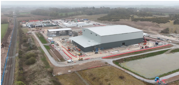
Station de conversion de Ballyadam, en Irlande.
