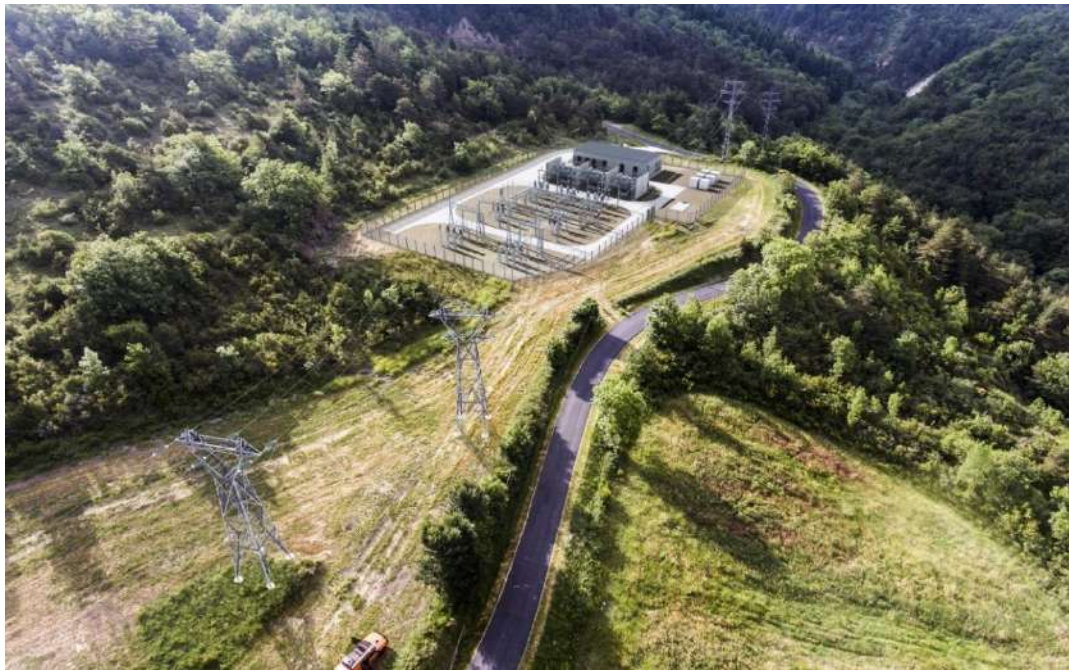
Poste 63 000 Volts de FONDAMENTE (Aveyron)
