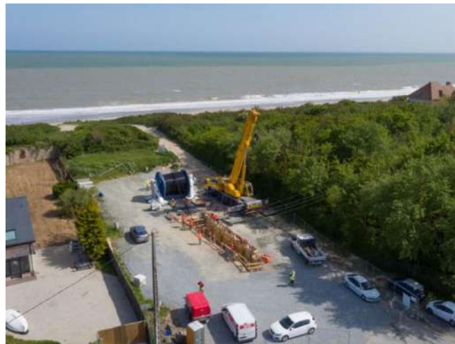
Figure 14 : Exemple d'une chambre de jonction d'atterrage avant comblement (Interconnexion France-Angleterre - IFA2)
