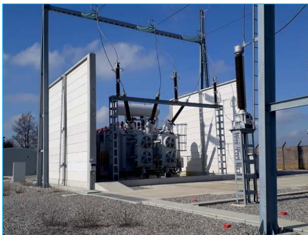
Transformateur dans un poste très haute tension
