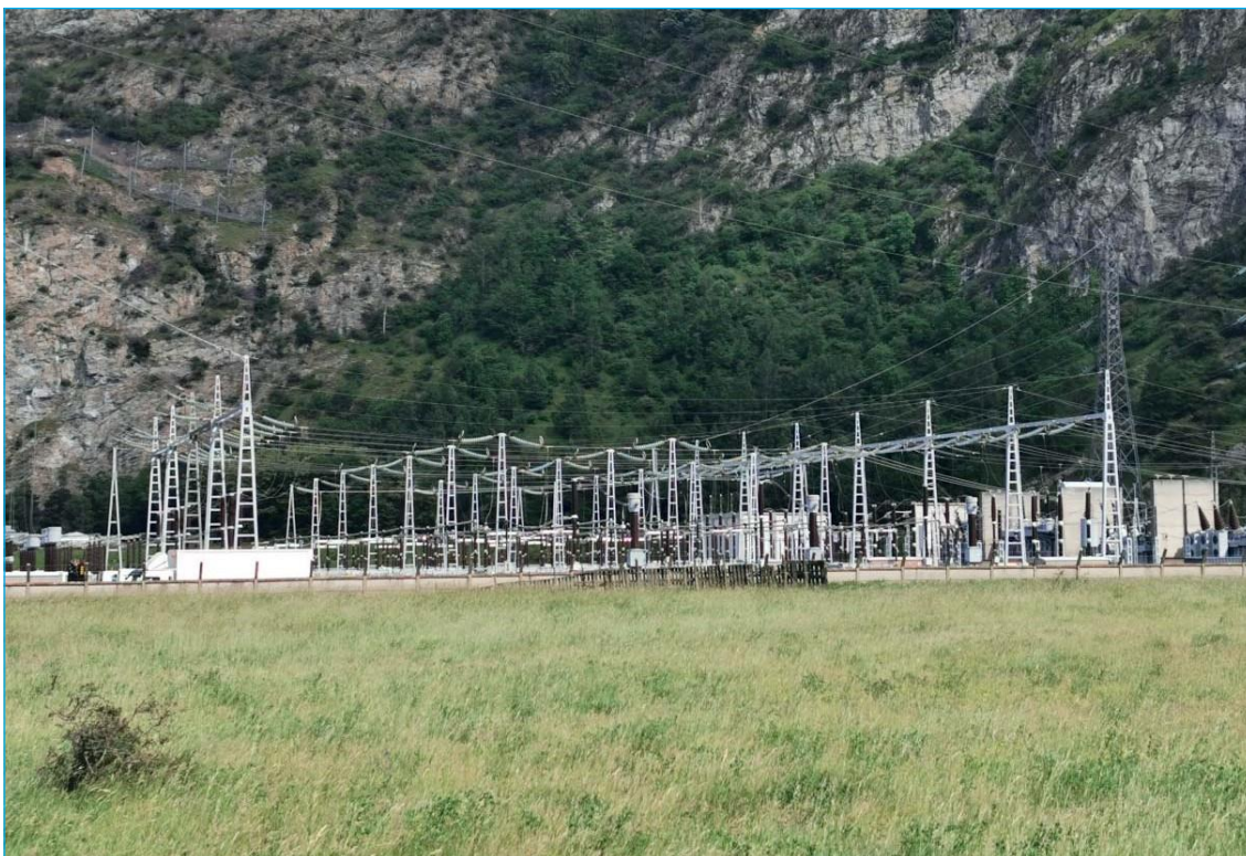
Exemple d'un poste aérien très haute tension
