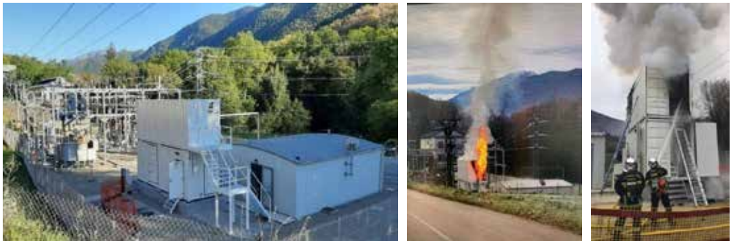
Figure 12 — Les deux conteneurs du dispositif de stockage grid-forming et multi-service OSMOSE au poste de Le Castelet (Ariège) avant incendie, puis lors de l'incendie le 01/12/2020.
