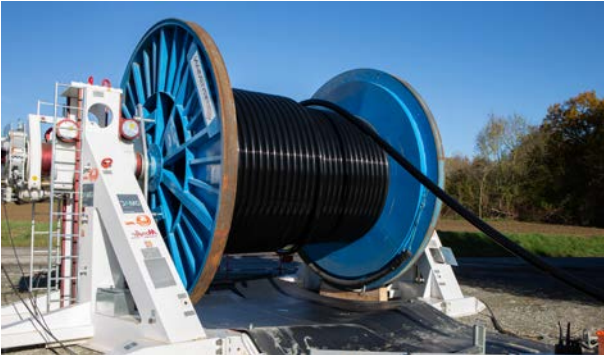
Toret de câble électrique
