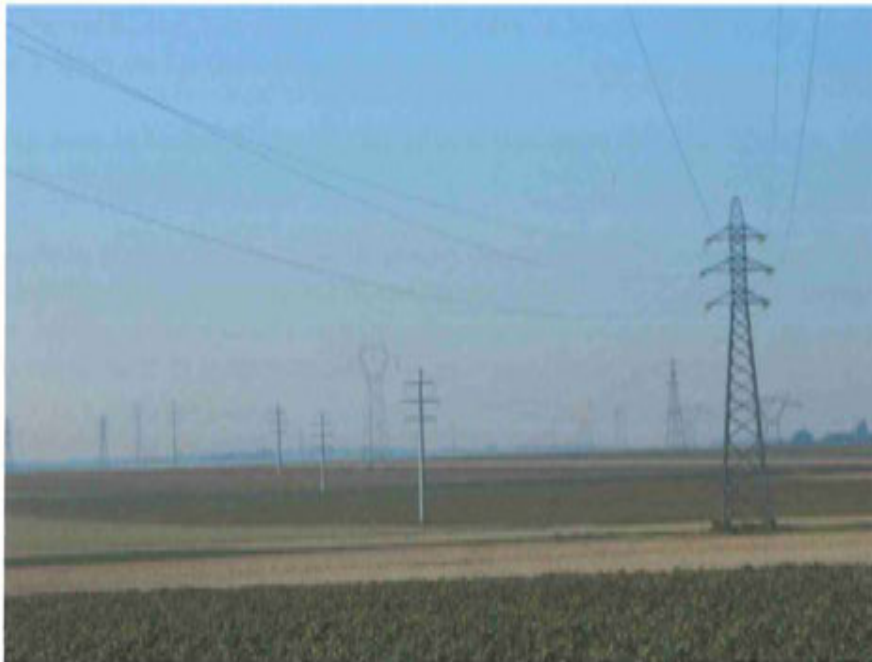
Photo a : L'actuelle ligne Avelin- Gavrelle 400 KV
