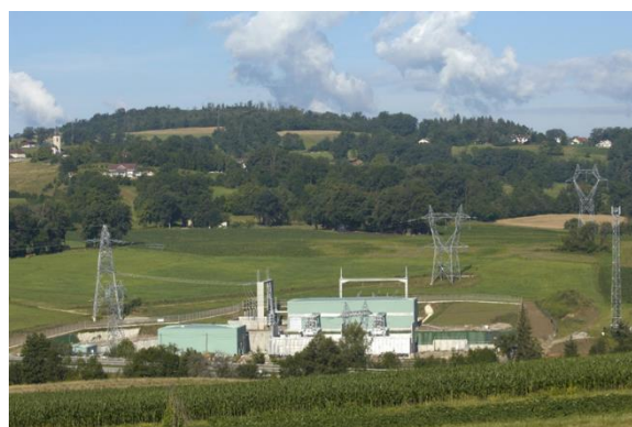
Le poste 400 000/63 000 volts de Montagny-les-Lanches au Nord d'Annecy : exemple d'un poste comparable au poste Oisans Nord
