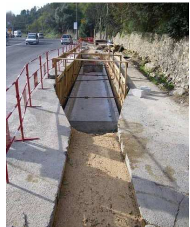
Chambre de jonction (Source RTE)
