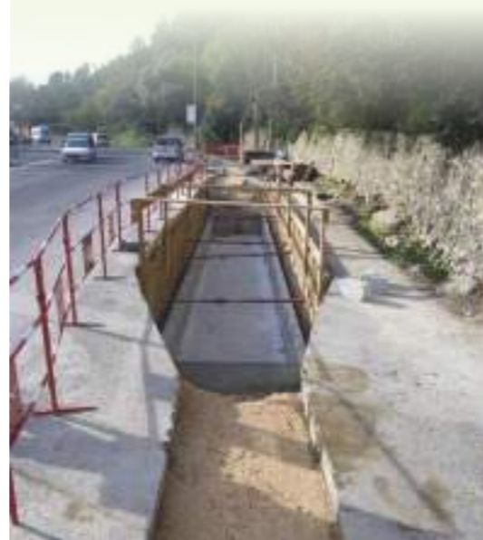
Chambre de jonction terrestre
