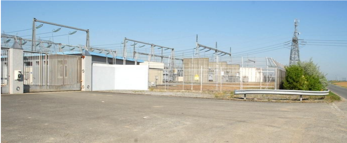
Les installations du poste électrique de Gavrelle.
