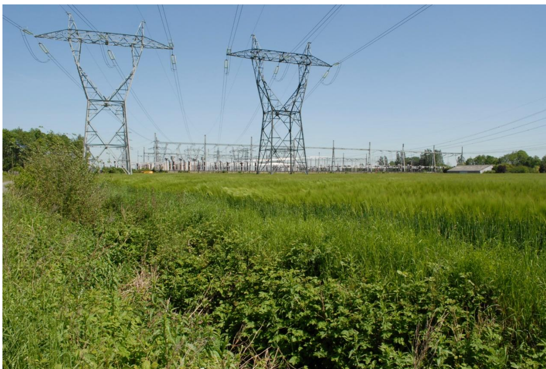
Vue d'ensemble du poste électrique d'Avelin.
