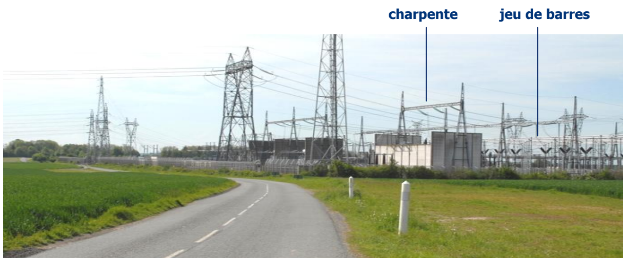
Charpentes et jeux de barres au poste de Gavrelle.
