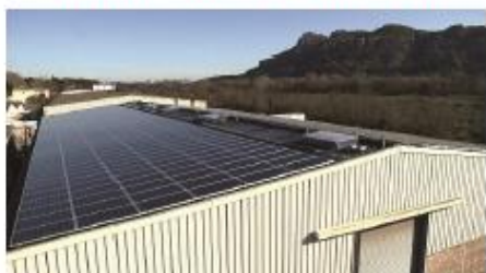
Exemple d'une installation photovoltaïque sur bâtiment
