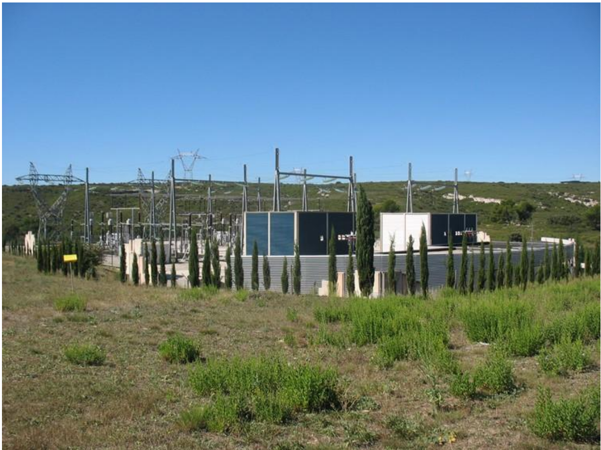
Vue du poste 225 000 / 20 000 volts de La Duranne (commune d'Aix-en-Provence)
