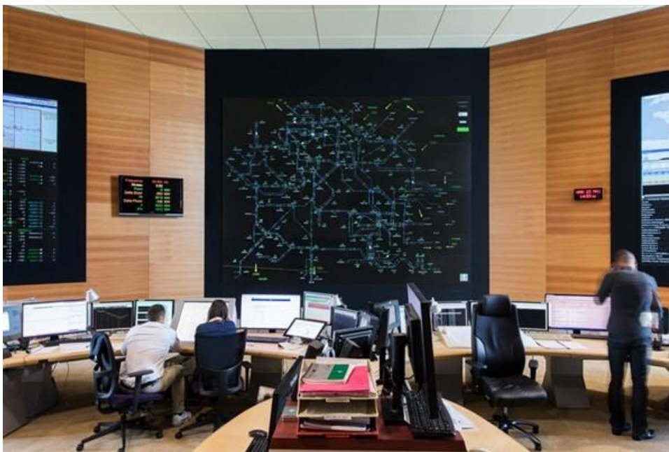
Salle de téléconduite (dispatching) du réseau RTE
