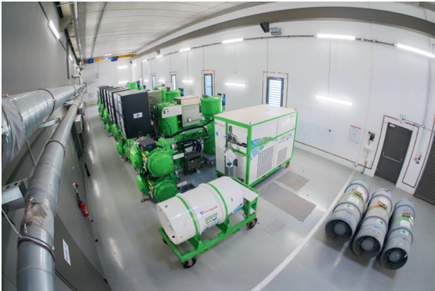
Figure: Poste 63 kV de GRIMAUD: expérimentation du premier poste RTE à gaz isolant à faible effet de serre, mis en service en juin 2019.
